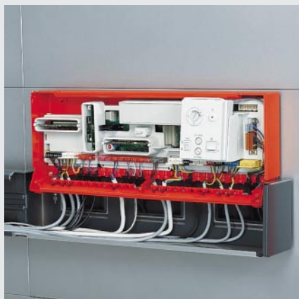
Der angebaute Kabelkanal ermöglicht eine saubere und ordentliche Kabelführung
